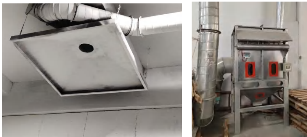
图 4-2 本项目废气治理设施
