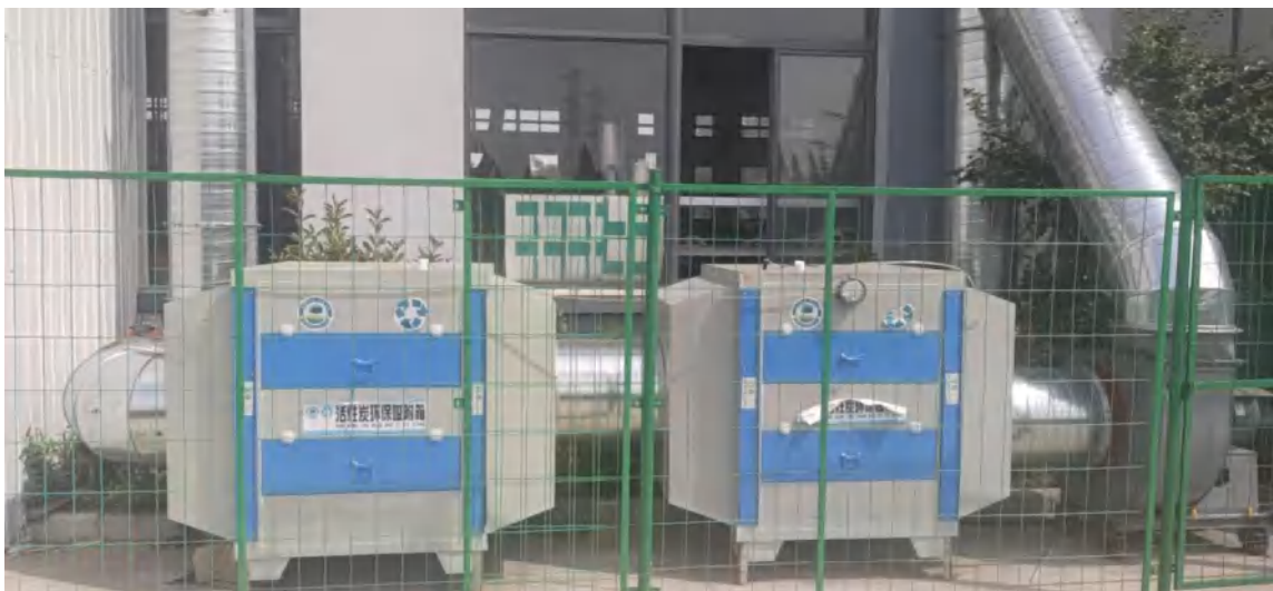
图 4-4 本项目主要废气治理设施
