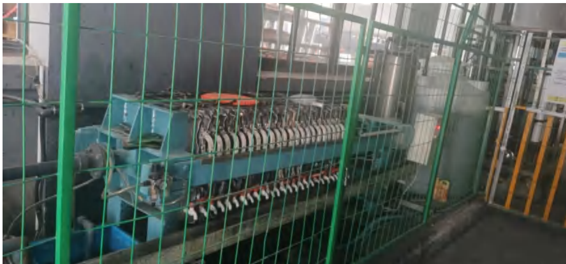
图4-2本项目胶辊清洗废水治理设施
