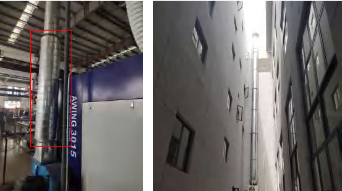
图 4-4 本项目激光切割烟尘废气治理图
