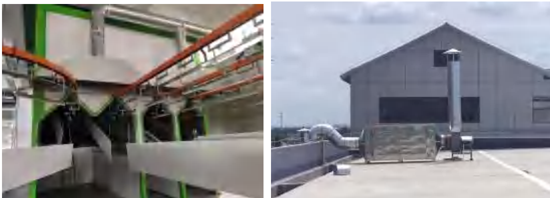
图 4-8 本项目烘干、固化废气治理设施图
