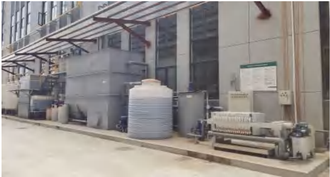
图 4-2 废水处理设施图
