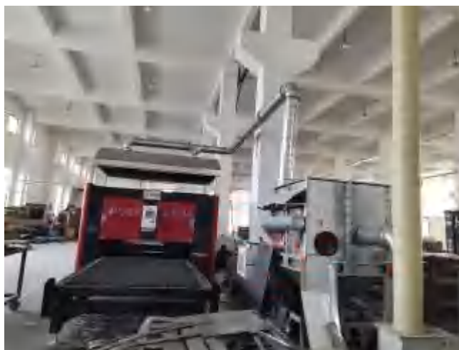
图 4-2 本项目切割烟尘治理设施
