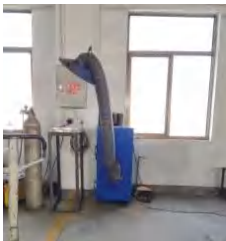
图 4-3 本项目焊接烟尘治理设施
