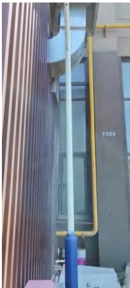
图4-4天然气废气排气筒图片
