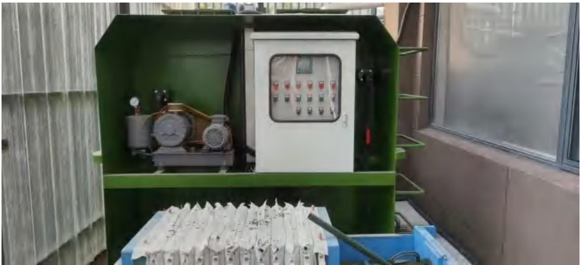
图 4-2 生产废水处理设施图片
