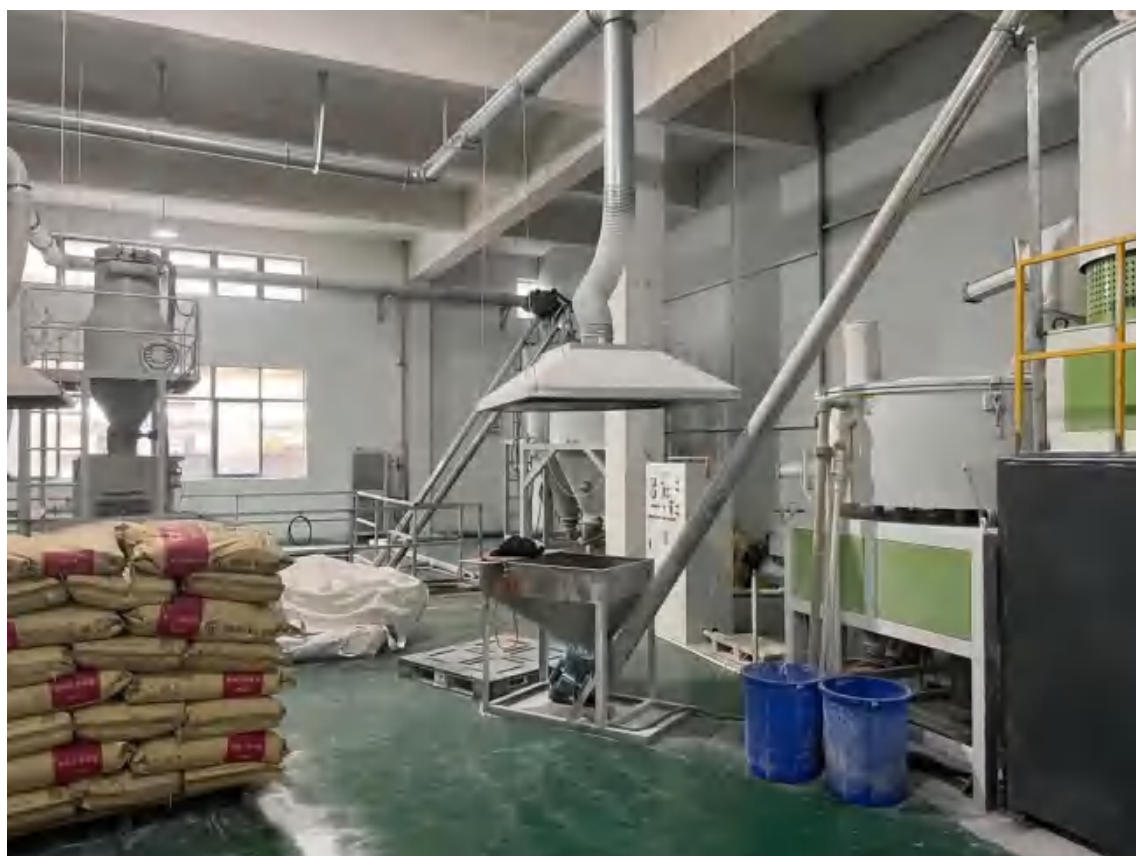
图 4-2 本项目投料工序废气收集设施图片
