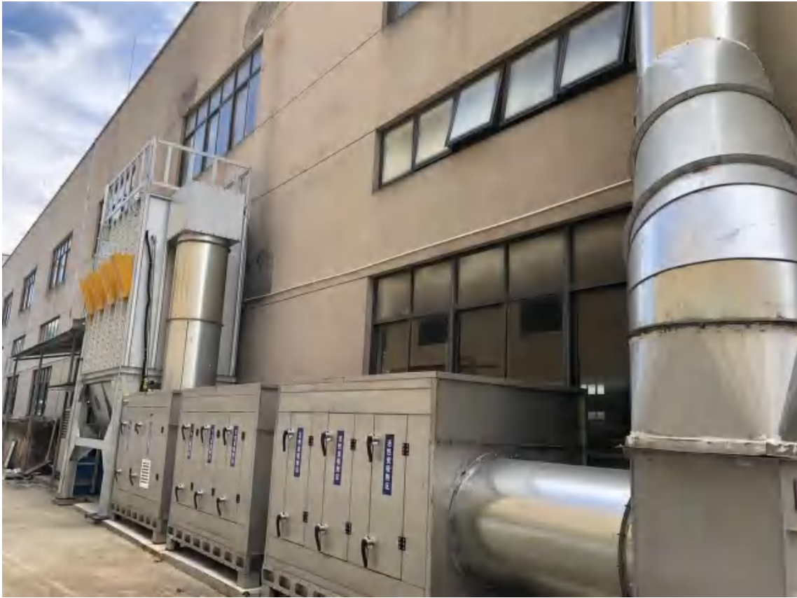
图 4-5 本项目废气治理设施图片
