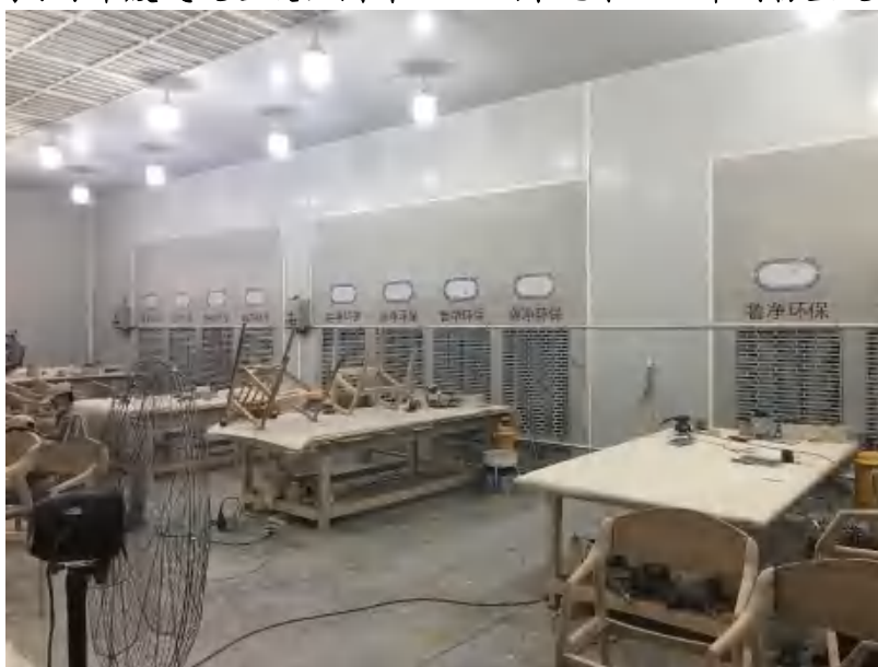
图4-6漆膜打磨粉尘处理设施图片
