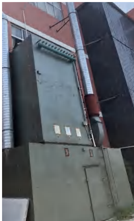
图4-5木加工车间粉尘处理设施图片
