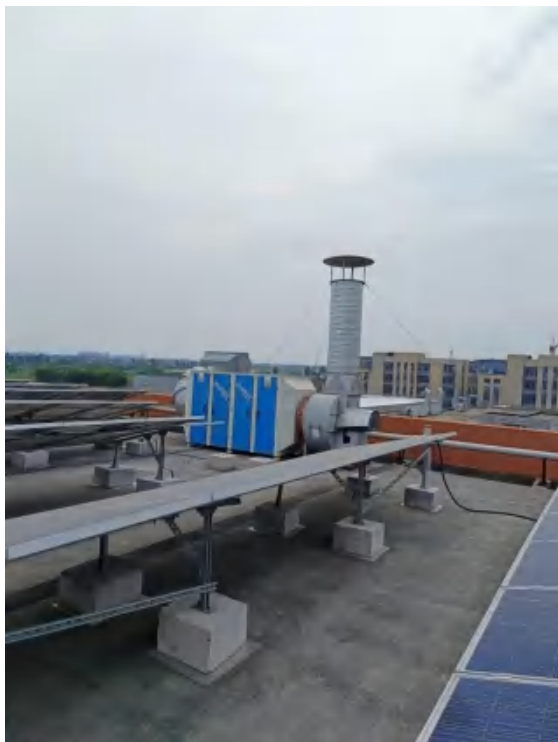
图4-4面漆、晾干废气处理设施图片
