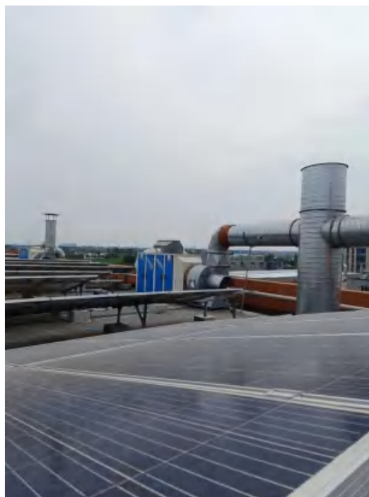
图4-3底漆、晾干废气处理设施图片
