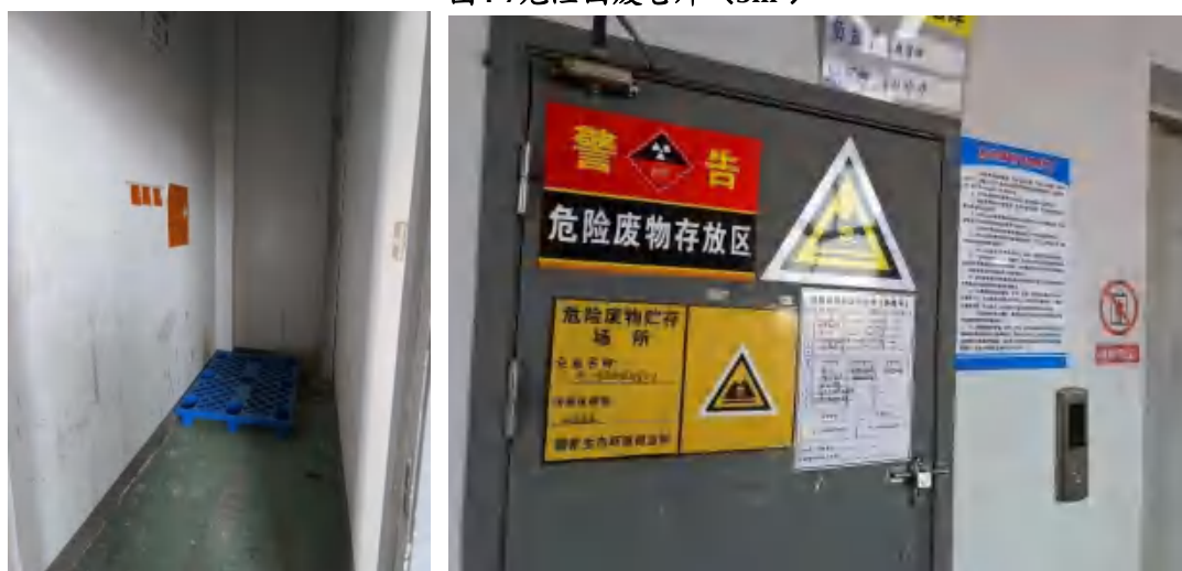
图4-8危险固废仓库（5m 2 ，三楼）
