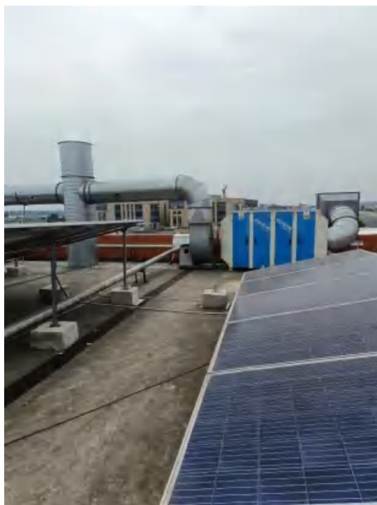
图4-2调漆废气处理设施图片
