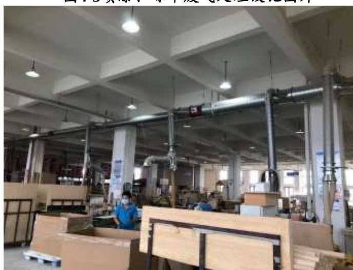
图4-6木加工粉尘收集设施图片
