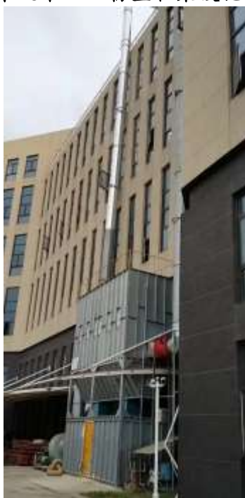
图4-7木加工粉尘处理设施图片
