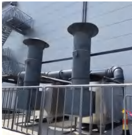
图 4-4 14#~15#废气处理设施
