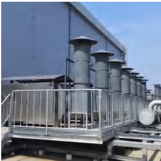
图 4-3 7#~13#废气处理设施
