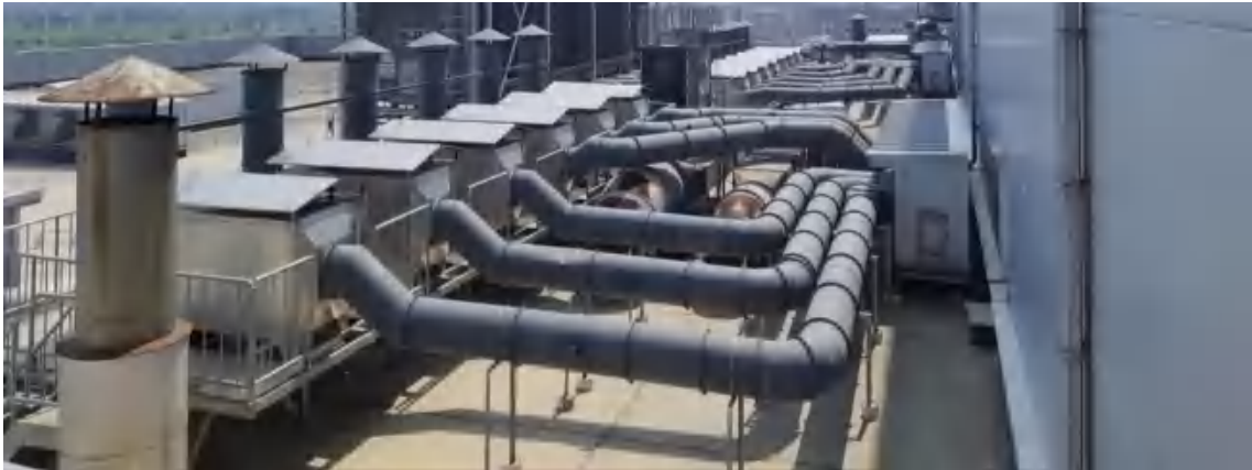
图 4-2 1#~6#废气处理设施
