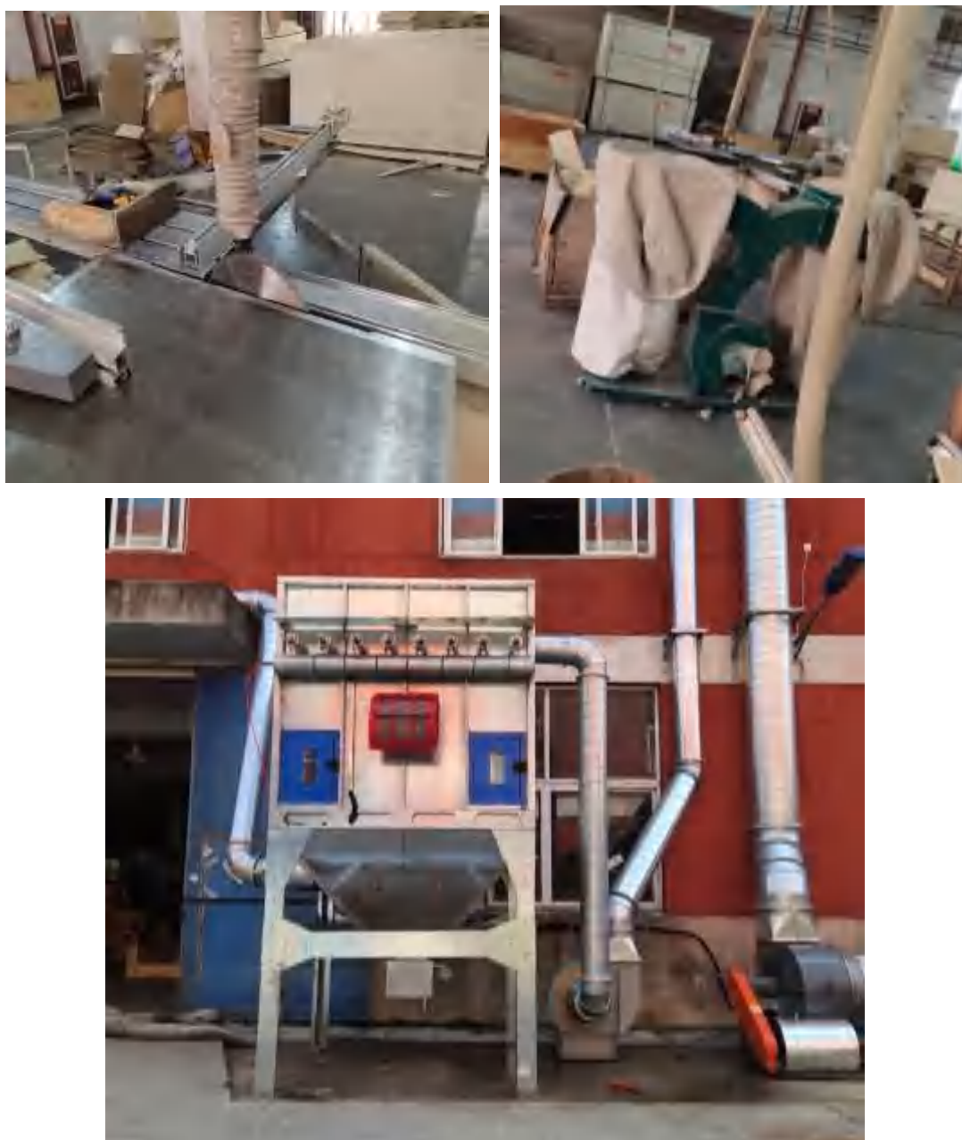
图 4-2 本项目木屑粉尘废气治理设施
