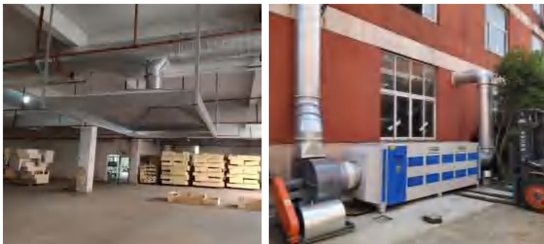
图 4-3 本项目胶水废气治理设施
