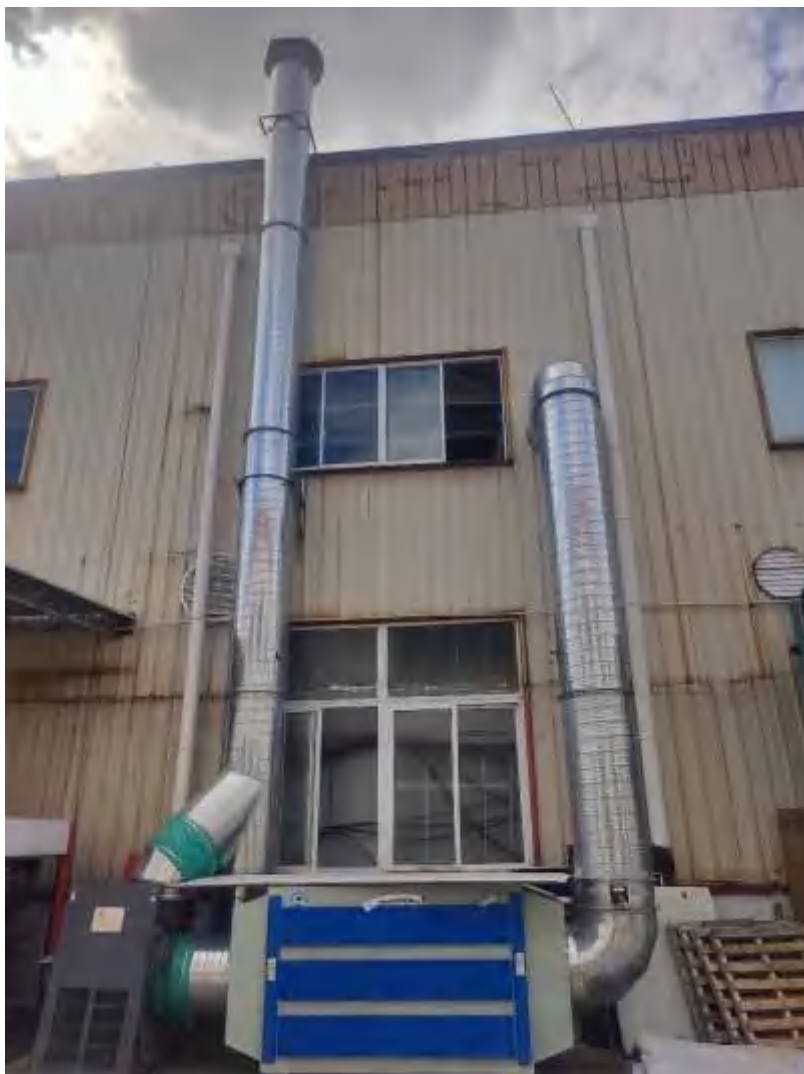
图4-2有机废气处理设施图片
