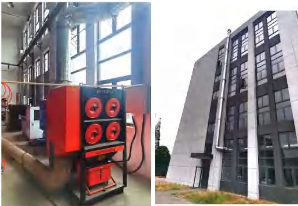
图 4-2 本项目激光切割工序废气处理设施图片
