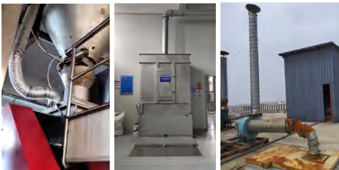
图 4-5 本项目投料混合废气治理设施
