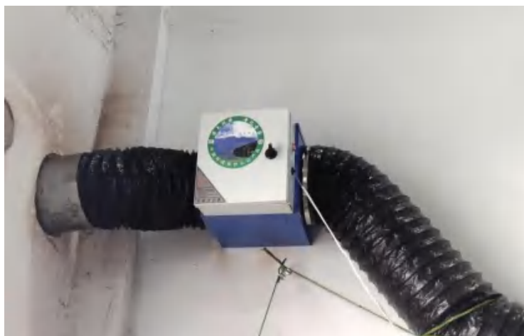
图 4-6 本项目食堂油烟废气治理设施
