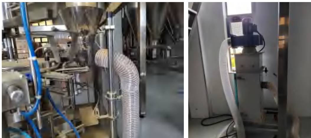
图 4-3 本项目包装废气治理设施
