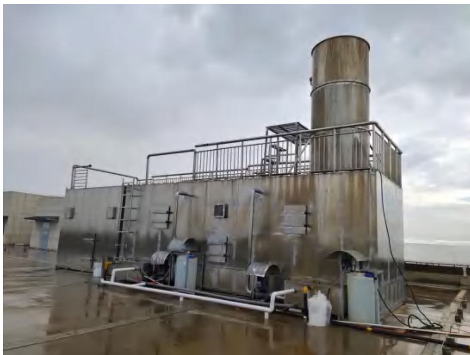
图 4-2 本项目生产废气治理设施
