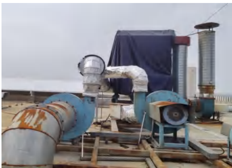
图 4-4 本项目粉碎废气治理设施
