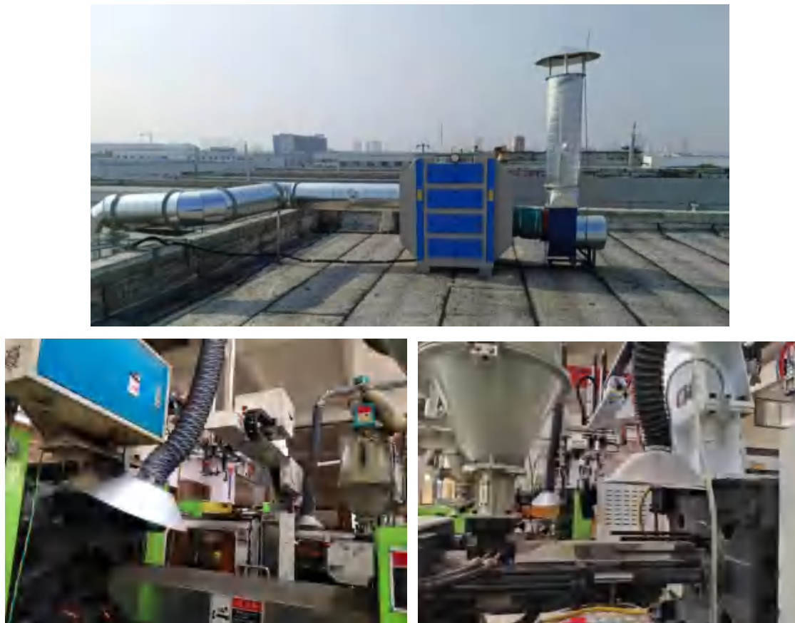
图 4-2 本项目主要废气治理设施
