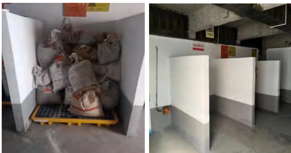
图 4-9 防渗漏托盘、环氧地坪漆和标志标贴
