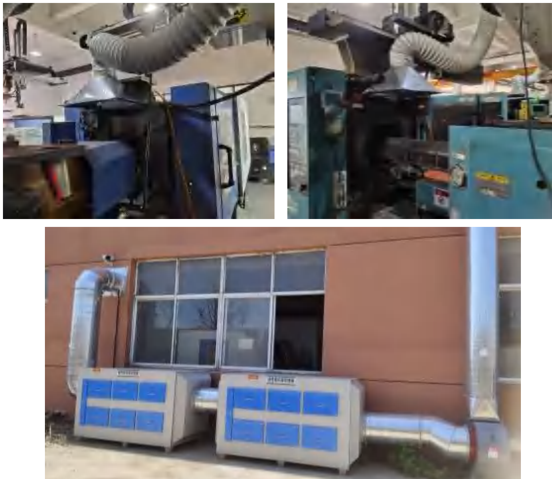
图 4-2 本项目塑料注塑废气治理设施
