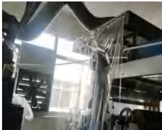
图 4-3 本项目印刷废气收集装置
