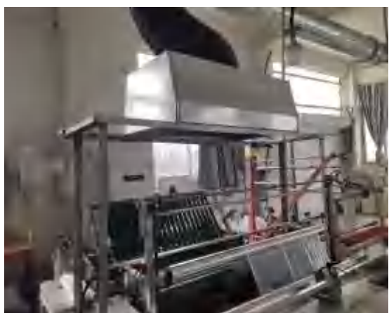
图 4-4 本项目制袋废气收集装置
