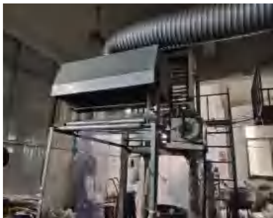
图 4-2 本项目吹膜废气收集装置
