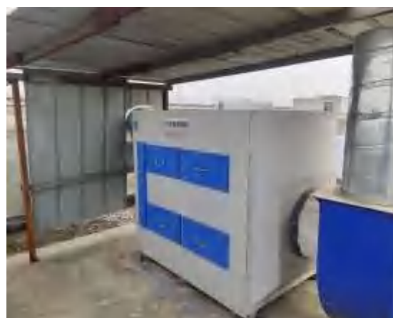
图 4-5 本项目有机废气治理设施
