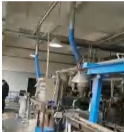
图 4-3 本项目喷码废气收集装置
