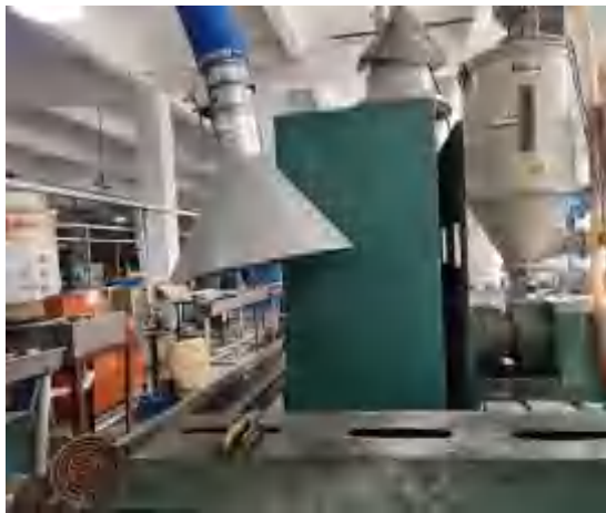
图 4-2 本项目挤出废气收集装置
