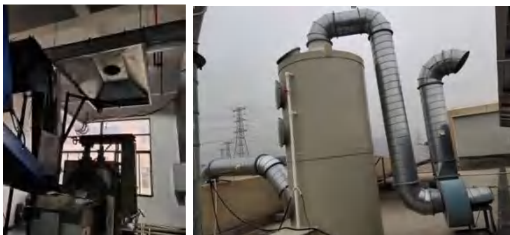
图 4-5 2#压铸废气处理设施
