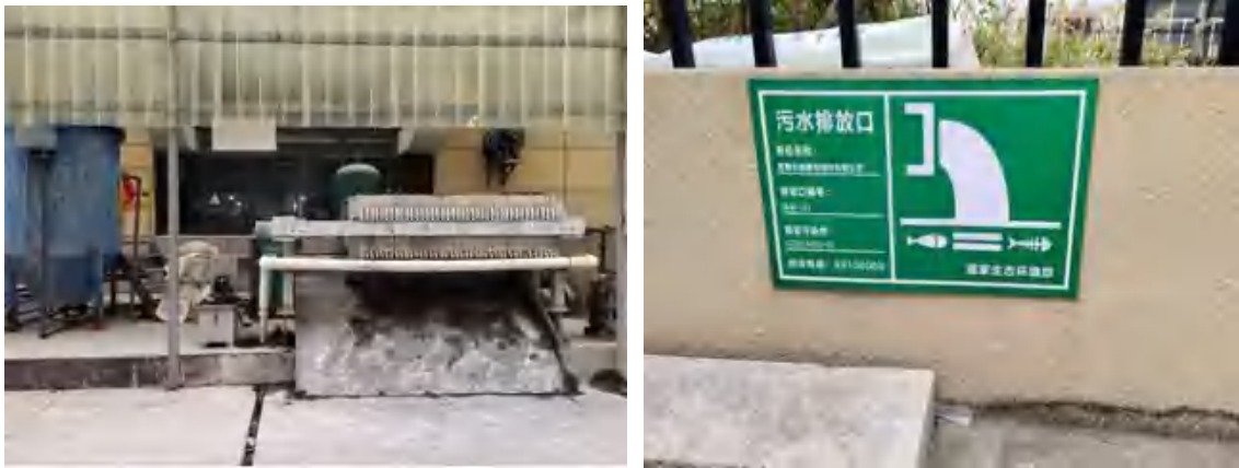
图 4-2 废水处理设施图
