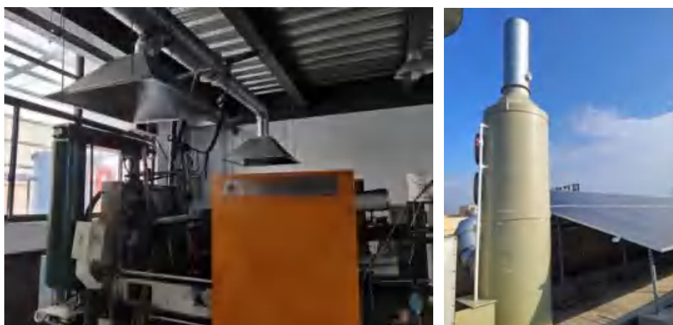
图 4-6 1#压铸废气处理设施
