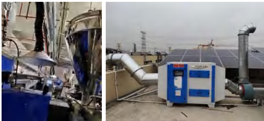
图 4-4 注塑废气处理设施
