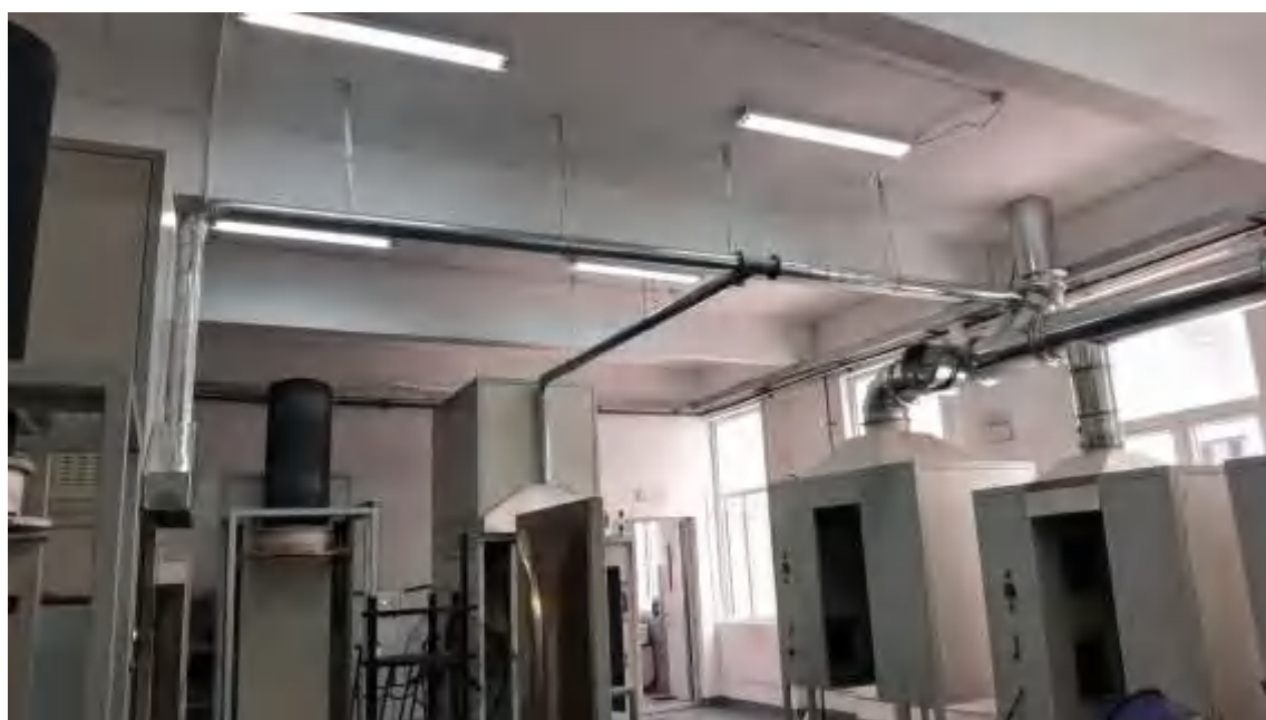
图 4-2 本项目烧结工序废气收集设施图片
