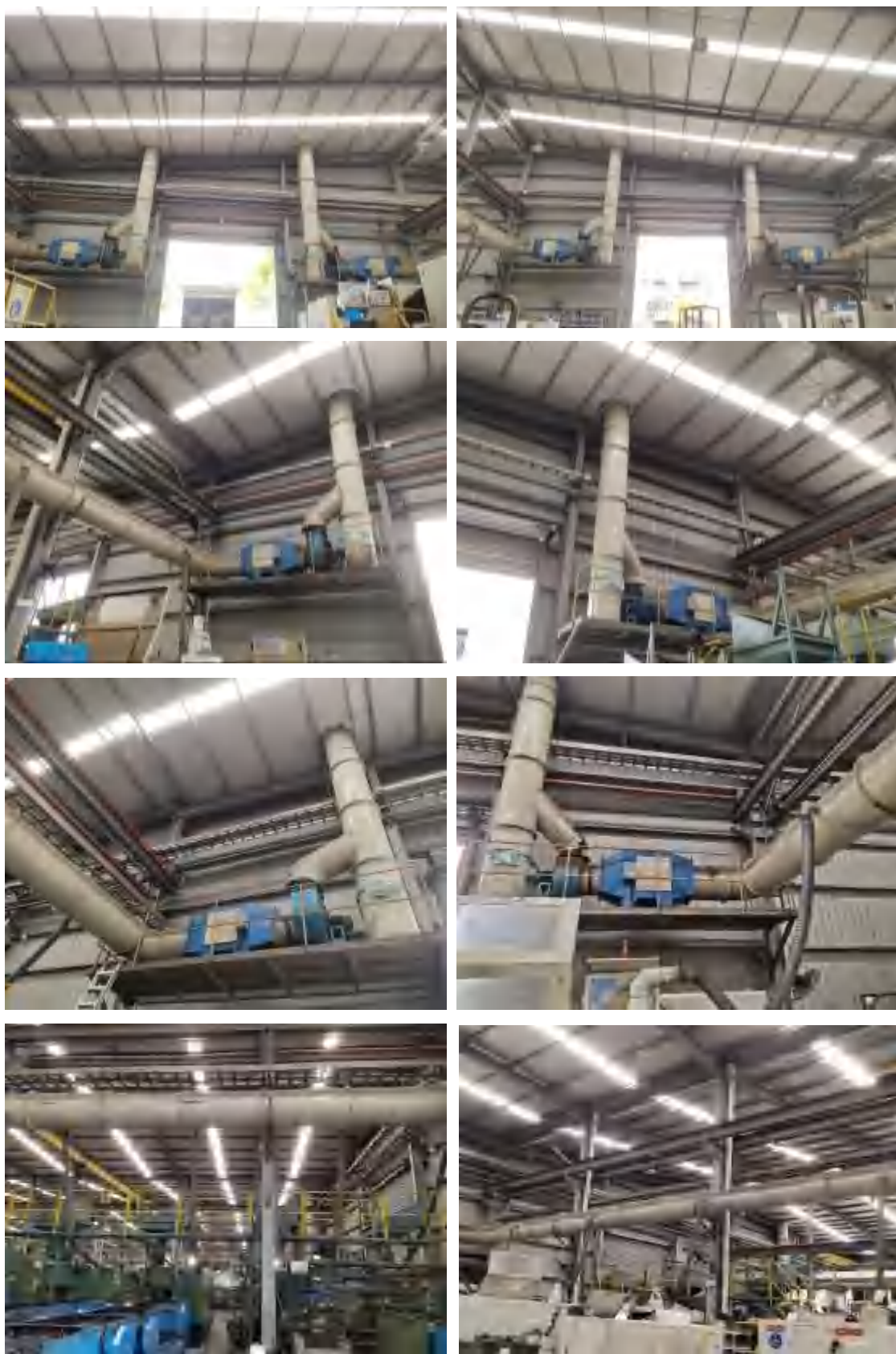
图 4-4 本项目成型油雾废气处理设施
