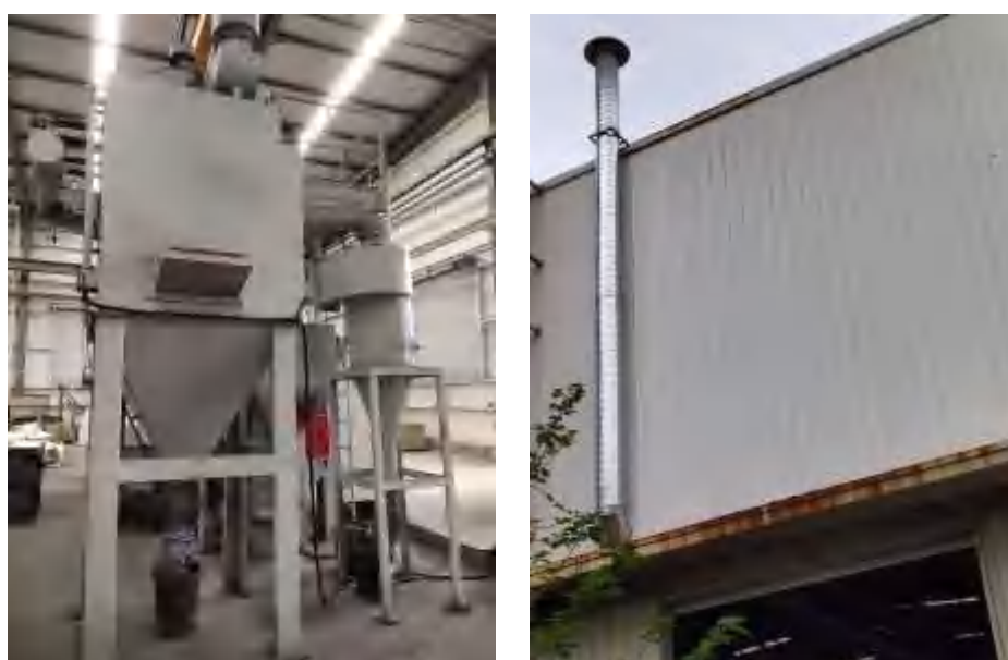
图 4-6 本项目喷砂粉尘处理设施
