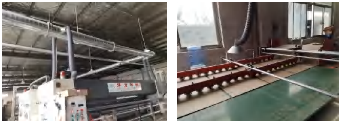
图 4-4 本项目主要废气治理设施
