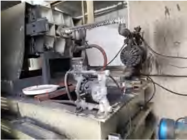
图 4-2 废水治理设施图
