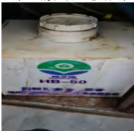
图 4-2 废水治理设施图
