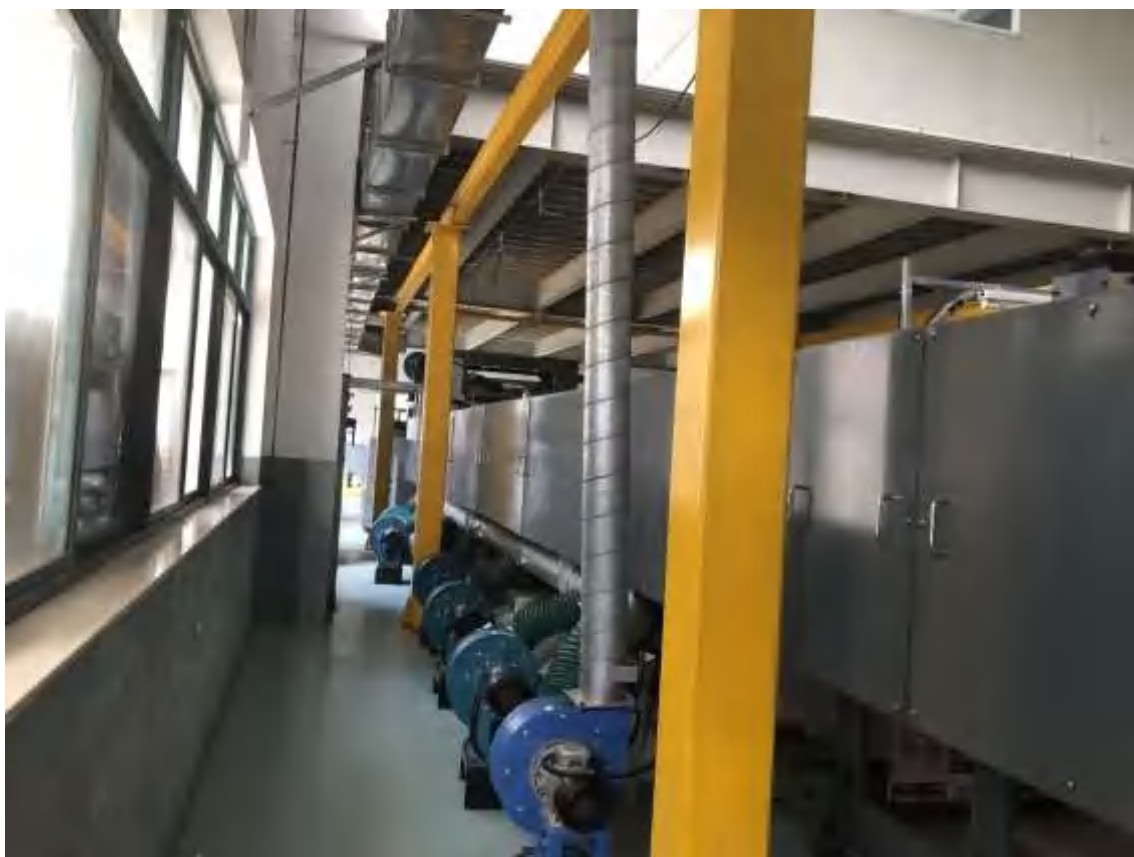
图 4-5 本项目印刷工序废气收集图片
