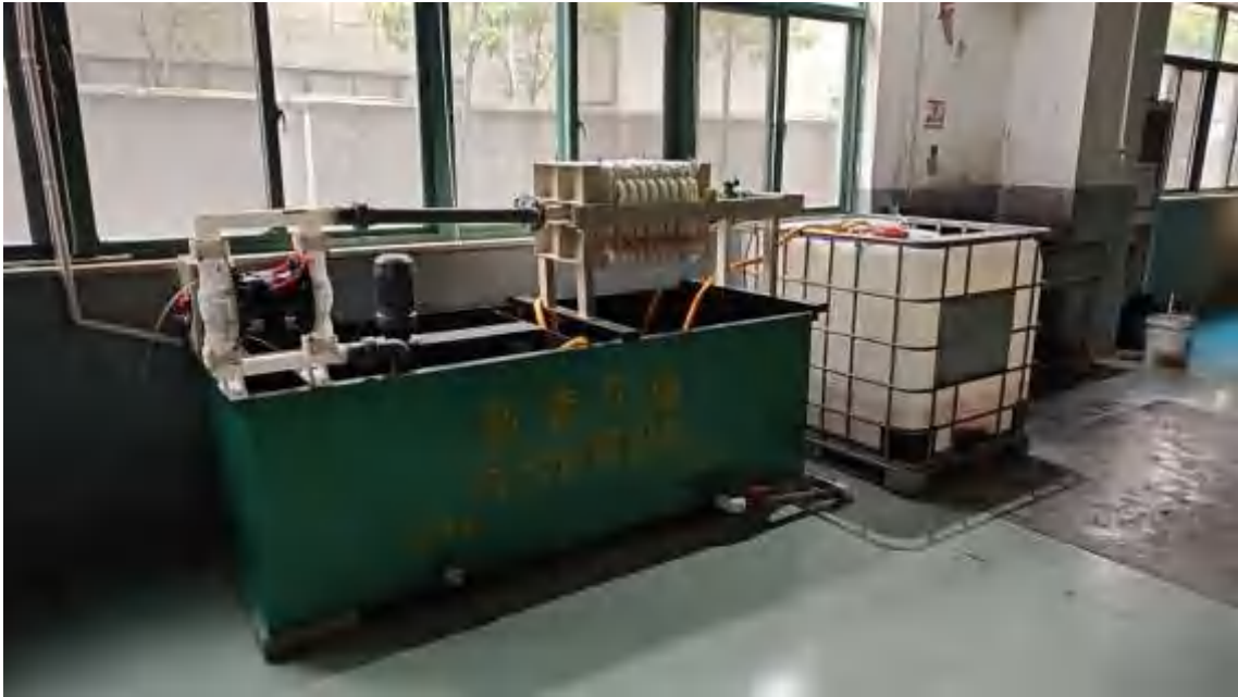
图 4-2 本项目生产废水处理设施图片
