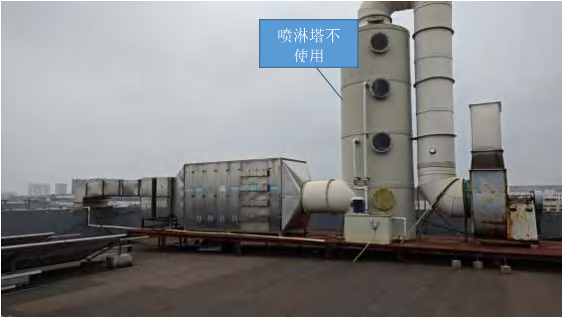
图 4-6 本项目活性炭吸附装置处理设施图片
