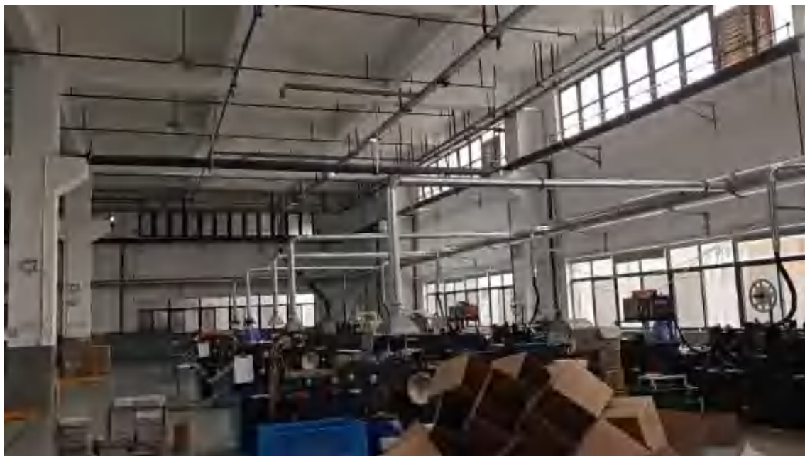
图 4-4 本项目糊盒工序废气收集图片
