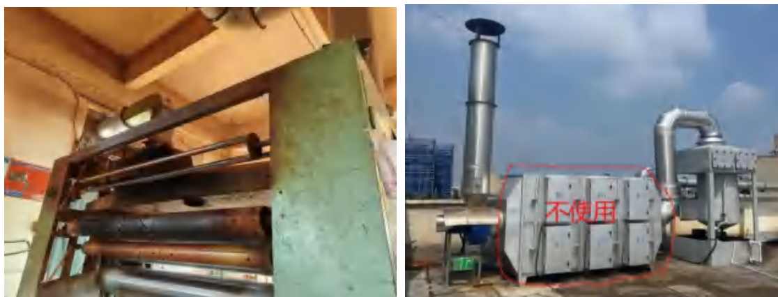
图 4-3 本项目火焰复合废气处理设施（等离子设备不使用）
