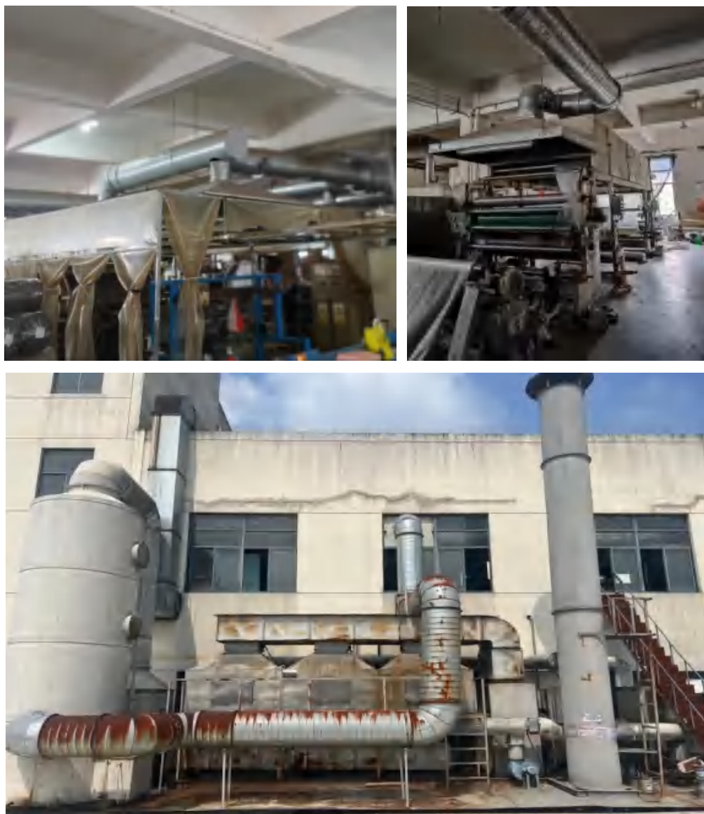
图 4-2 本项目油胶复合废气、烫金废气处理设施
