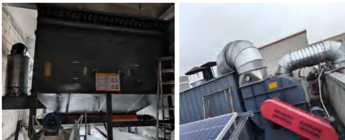
图 4-3 本项目 2#粉尘废气处理设施
