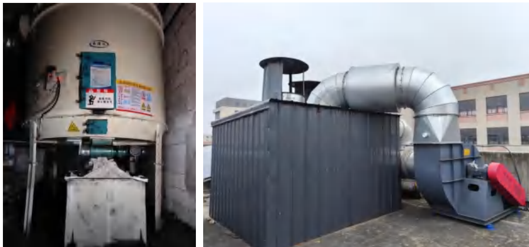
图 4-2 本项目 1#粉尘废气处理设施
