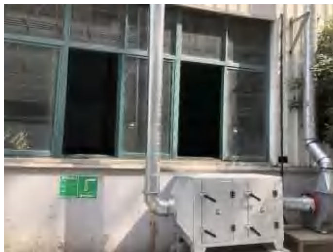
图 4-3 本项目污泥贮存间废气处理设施图片（活性炭吸附装置）
