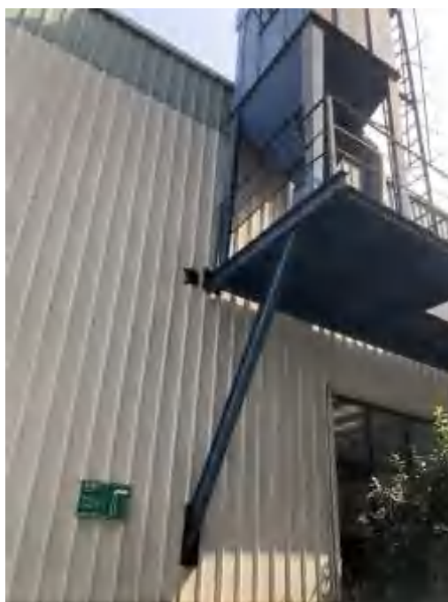
图 4-2 本项目卸料、分拣打包废气处理设施图片（布袋除尘装置）
