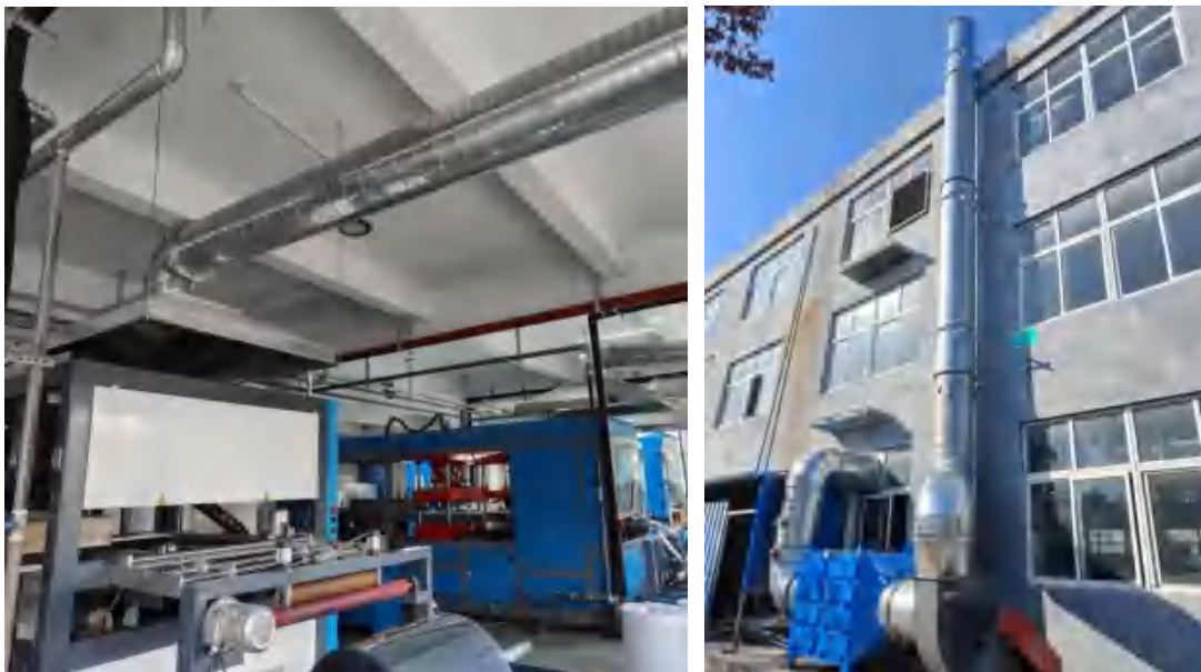
图 4-2 本项目主要废气治理设施
