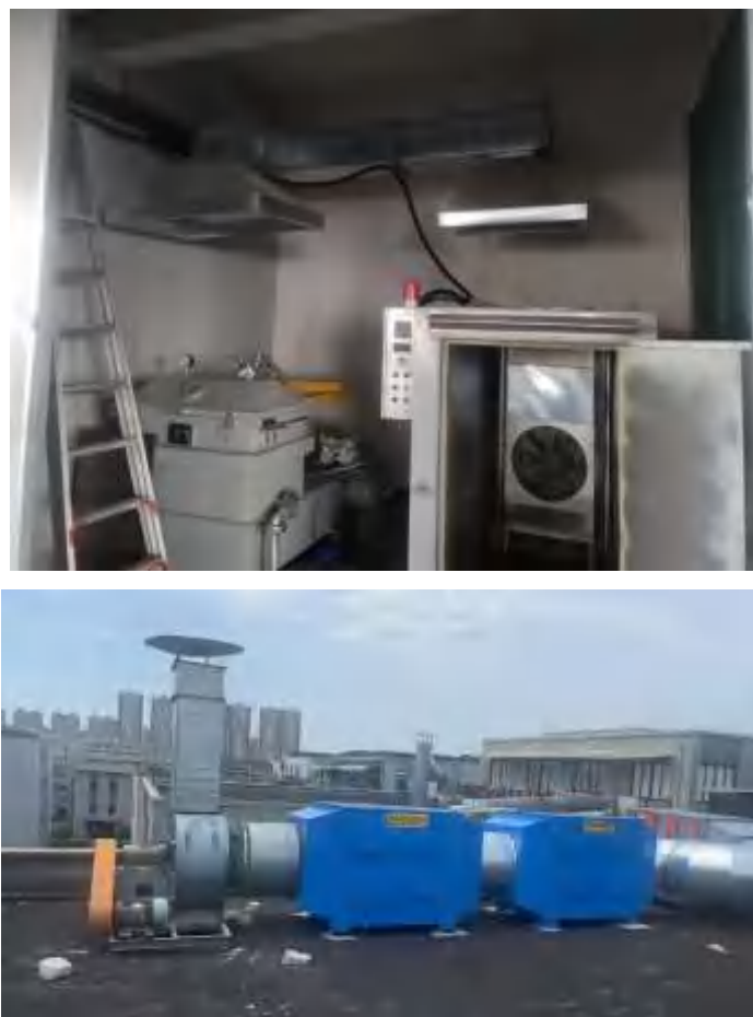
图 4-2 本项目浸漆、烘干工序废气处理设施图片
