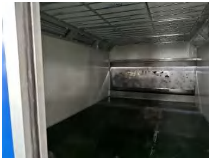
图 4-5 本项目喷漆房水帘设施图片
