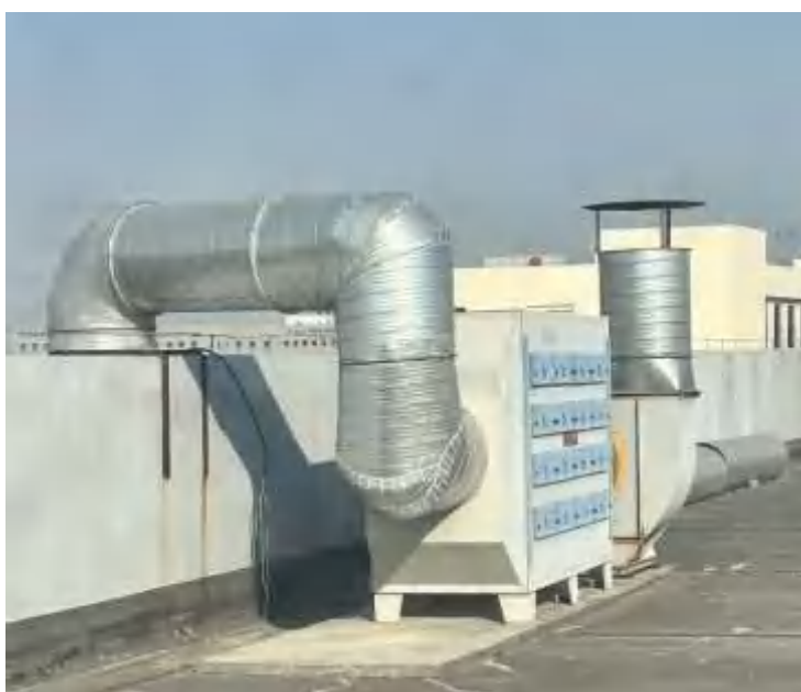
图 4-6 本项目喷漆、烘干废气处理设施图片
