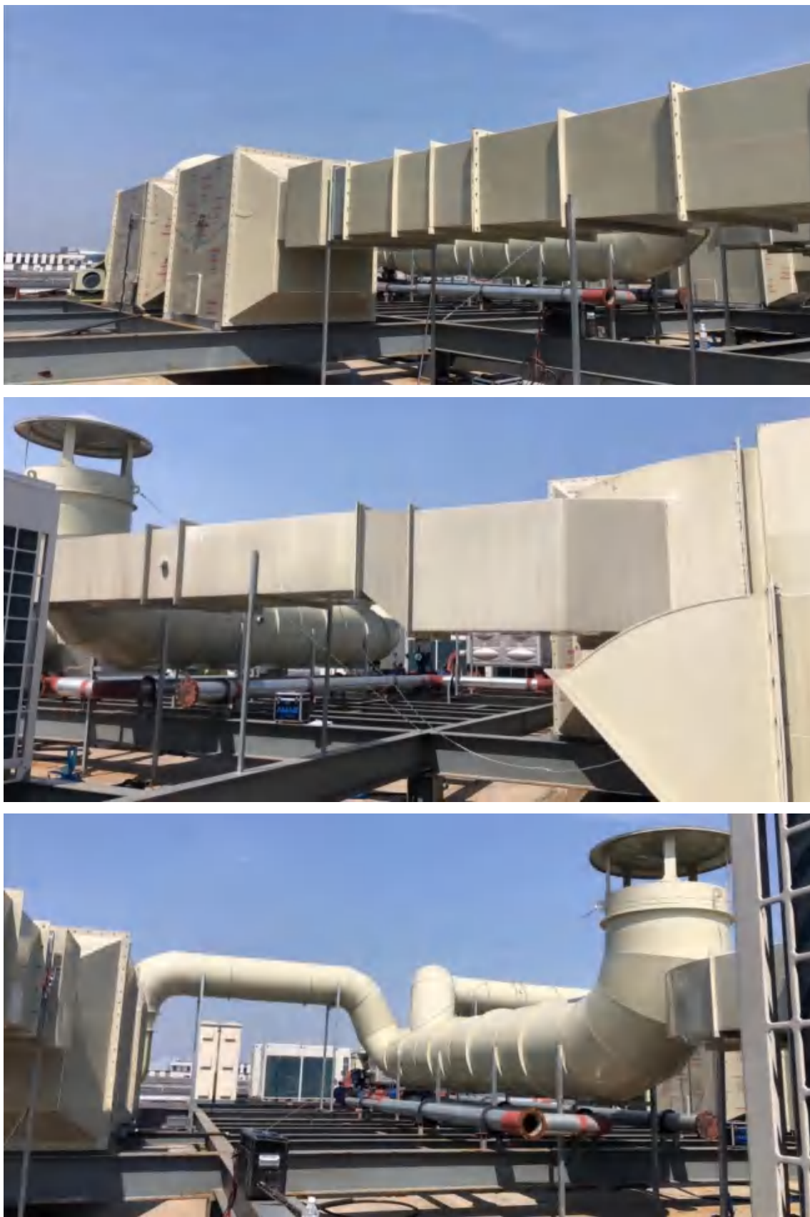
图 4-6 本项目 DA003 排气筒照片
