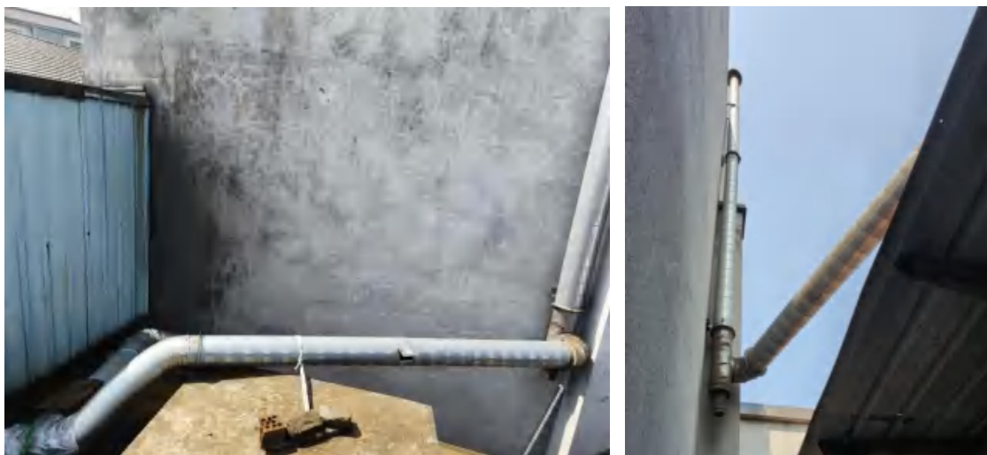
图 4-4 本项目废气排气筒
