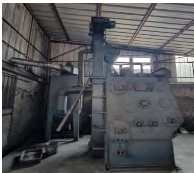
图 4-3 本项目抛丸废气处理设施
