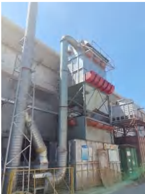
图 4-6 粉尘处理设施图片（布袋除尘装置）
