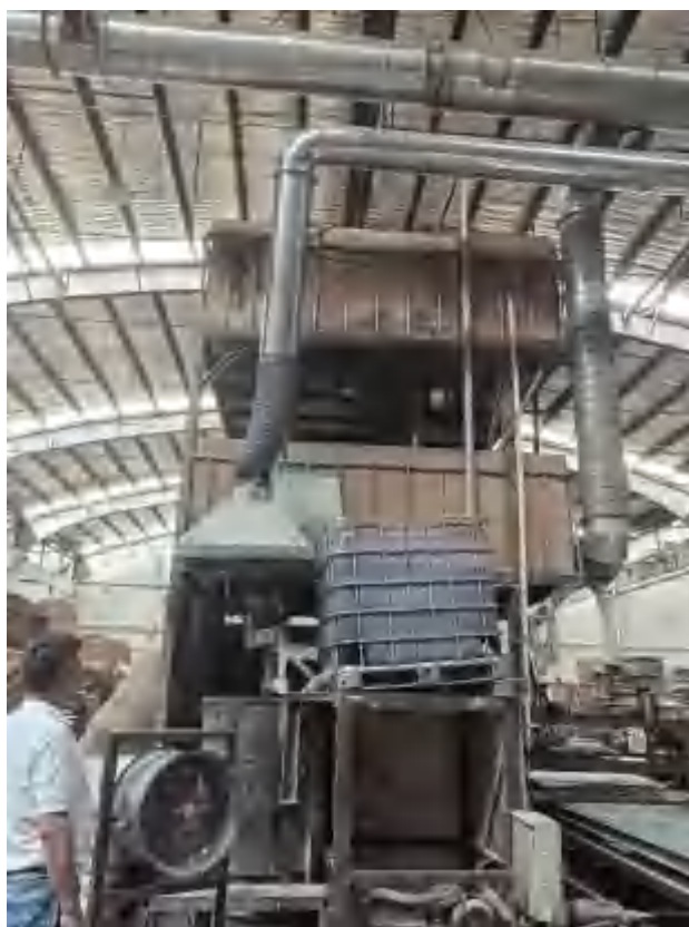
图 4-4 本项目投料粉尘收集设施图片
