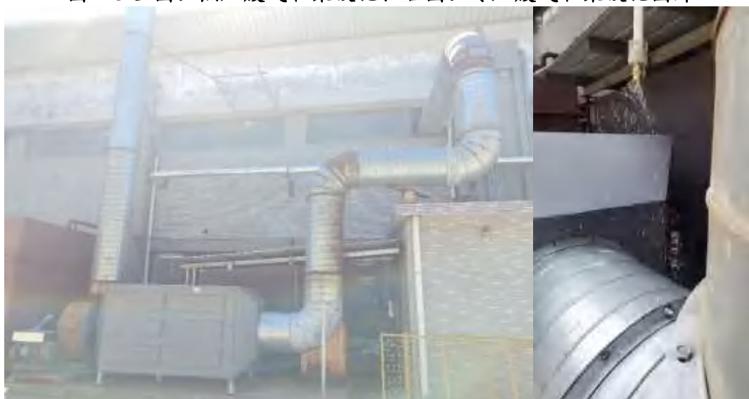
图 4-9 胶水废气处理设施图片（喷雾+二级活性炭吸附装置）
