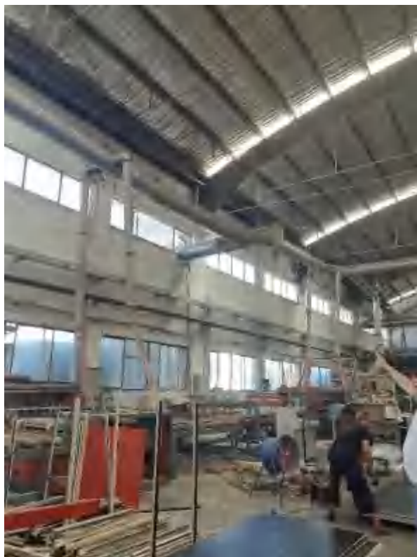
图 4-5 木加工粉尘收集设施图片
