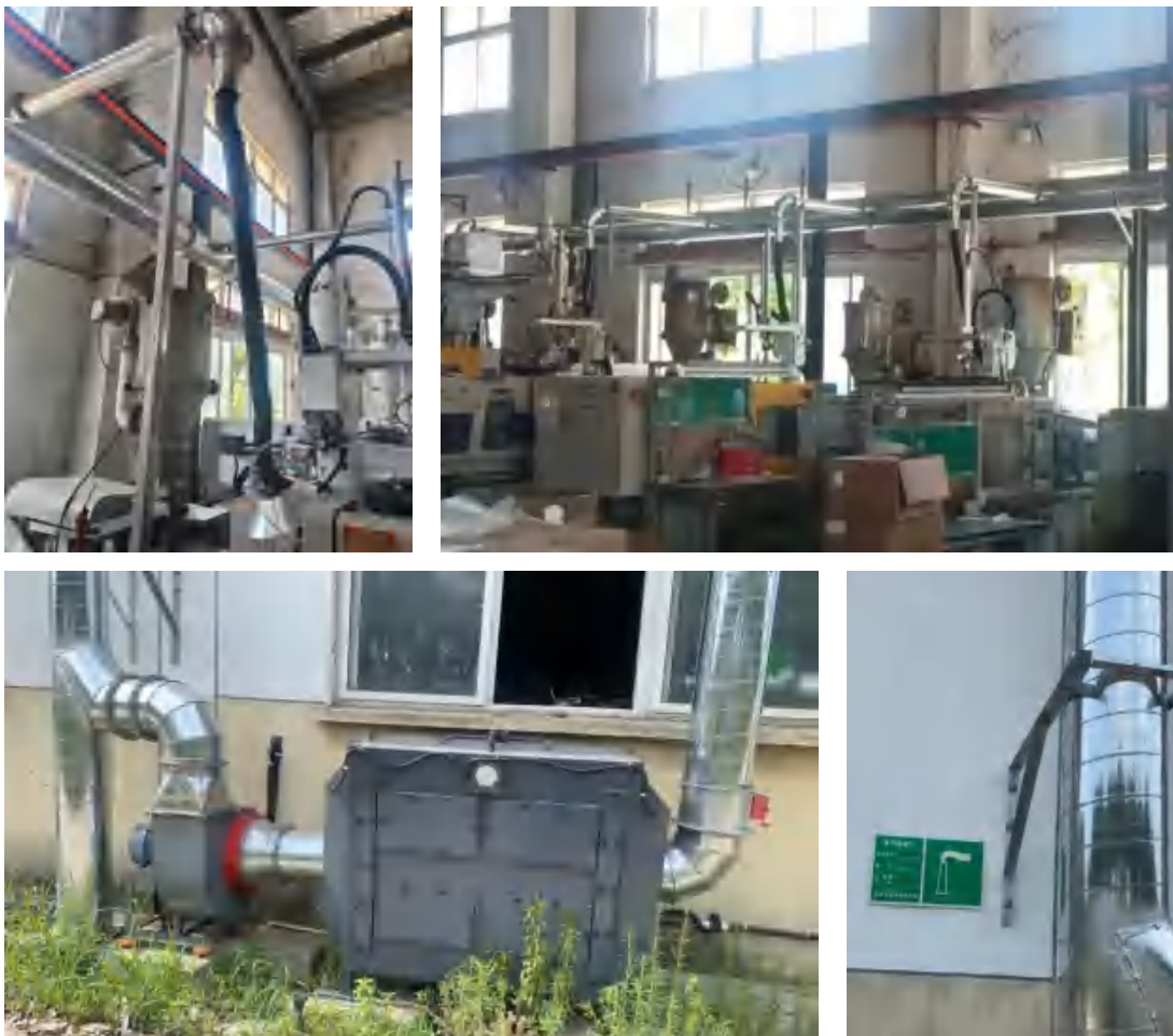
图 4-2 本项目注塑废气处理设施图
