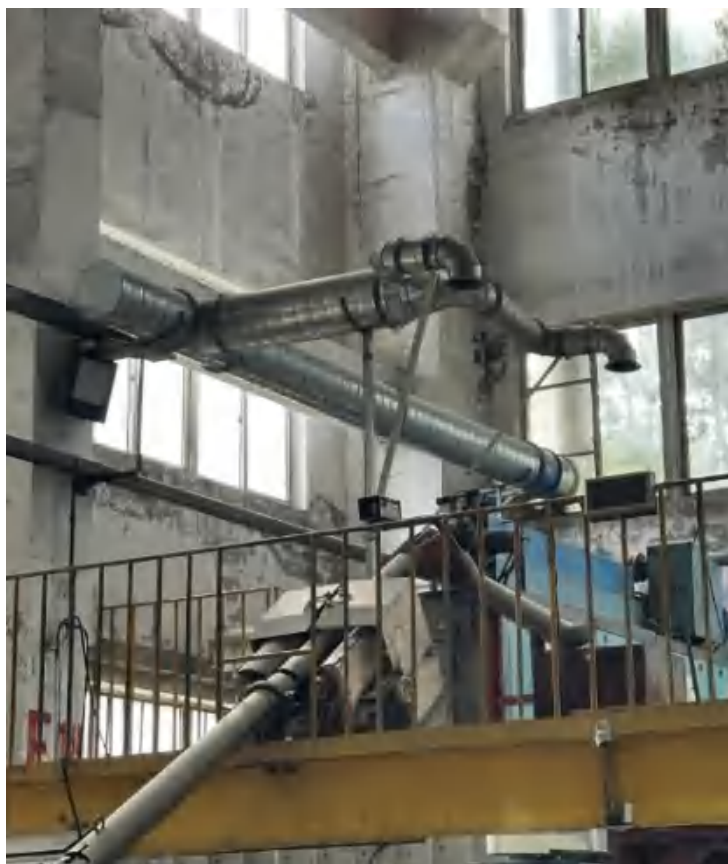
图4-2本项目主要废气治理设施
