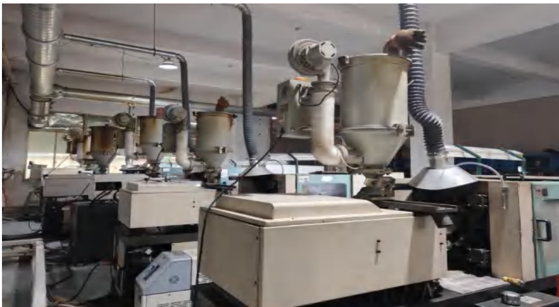
图 4-4 本项目注塑废气集气罩收集
