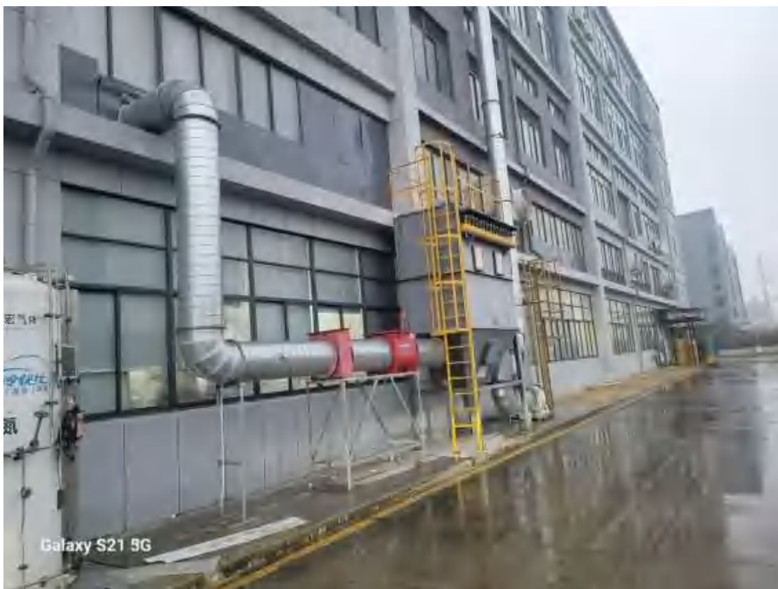
图 4-4 本项目铜粉烧结工序废气处理设施图片
