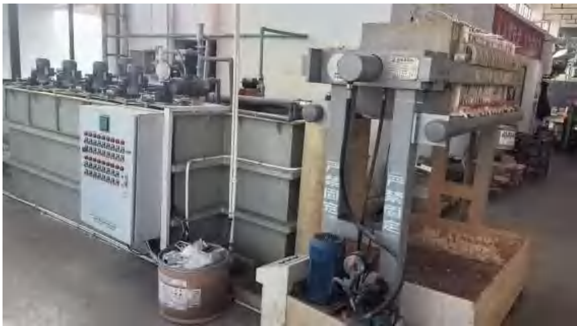
图4-2本项目抛光废水处理设施图片
