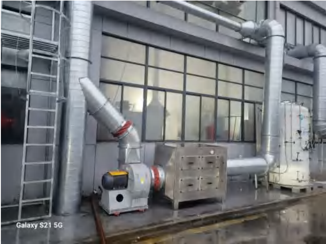
图 4-5 面料烘干和熟化及胶水废气处理设施图片
