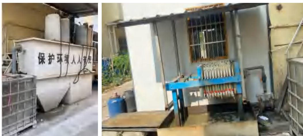
图 4-2 废水处理设施图
