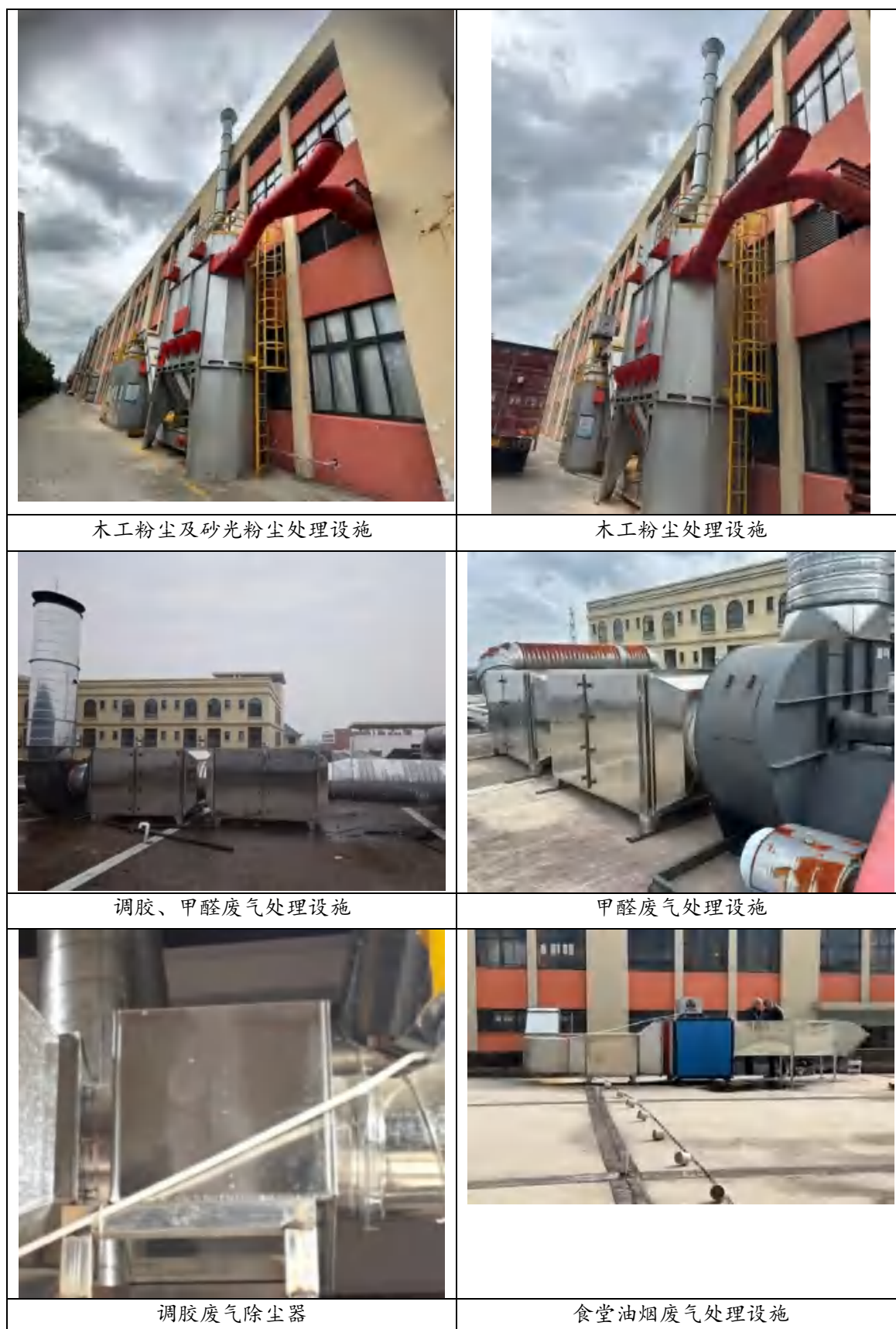
图4-2 废气治理设施照片
