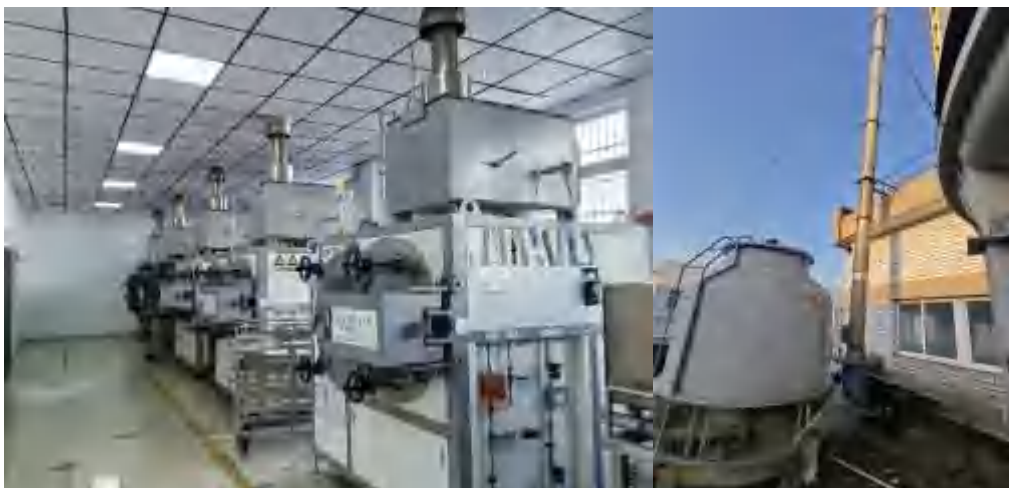
图4-5脱脂废气处理设施图片
