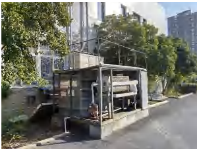
图4-2本项目生产废水处理设施图片
