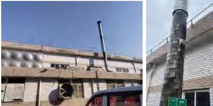
图4-4注射、烧结废气处理设施图片
