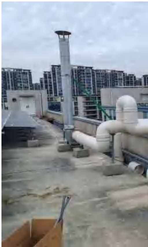
图 4-2 本项目焊接、补焊废气排气筒图片
